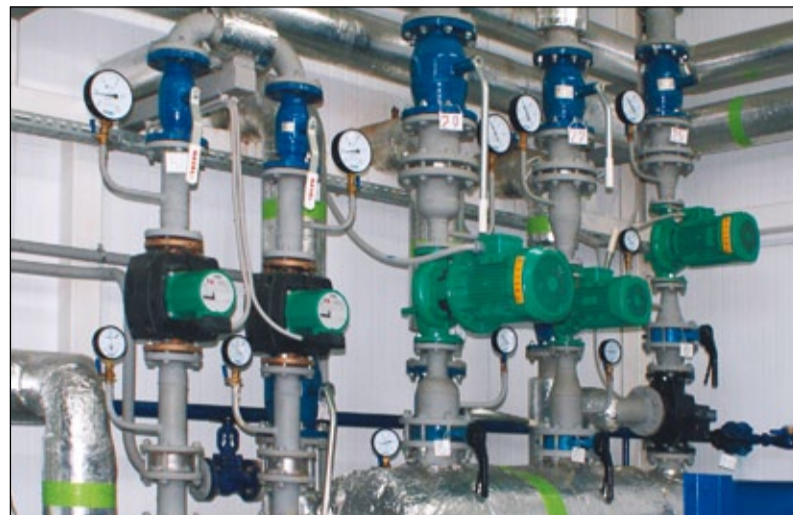
Внутреннее помещение котельной
